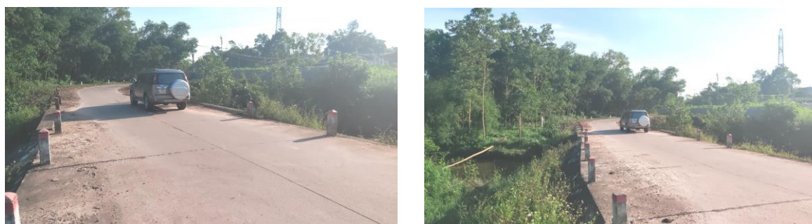
Hình 1. 3. Hiện trạng tràn Km5+098.5
